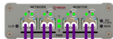
Link und Traffic auf allen Ports vorhanden; jeweils linke LED leuchtet dauerhaft und jeweils rechte LED blinkt
